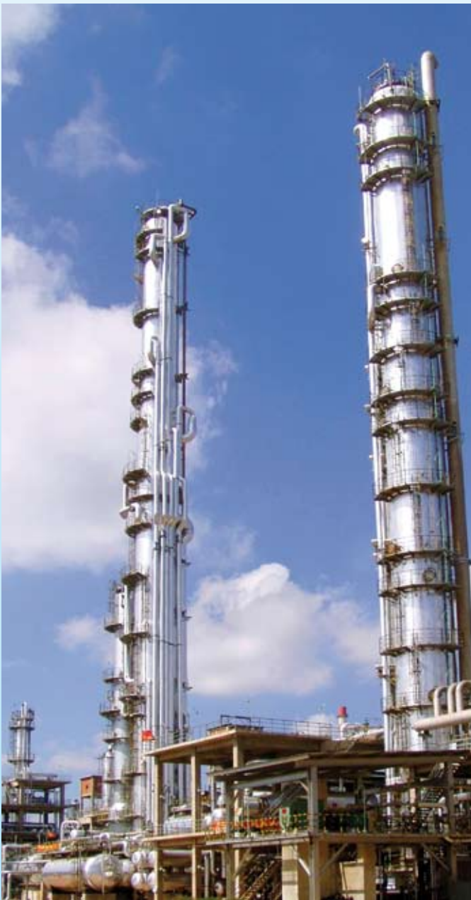
Anlage für eine chemische Wäsche
